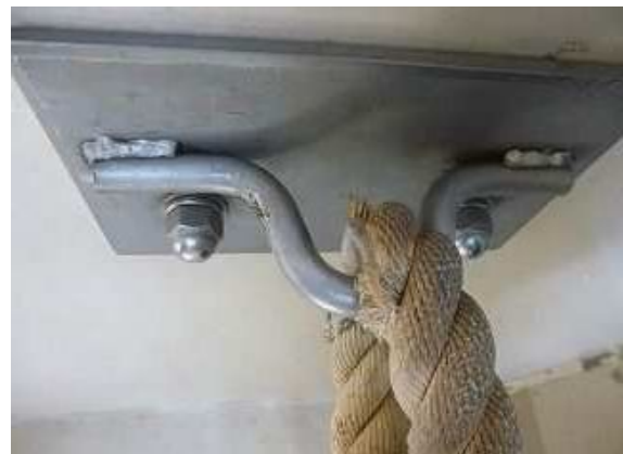
<指摘19 チンパンジー館ロープの劣化>
