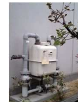
③ガス変換機接続口
