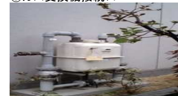
③ガス変換機接続口
