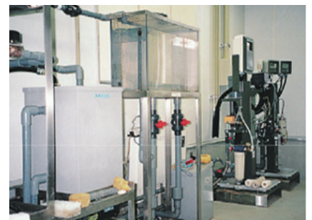
水質自動監視装置
