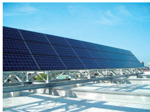
配水センターの太陽光発電設備
