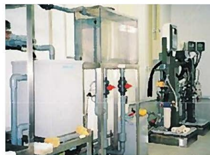
水質自動監視装置
