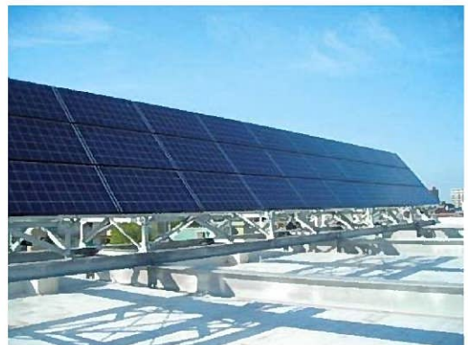
配水センターの太陽光発電設備
