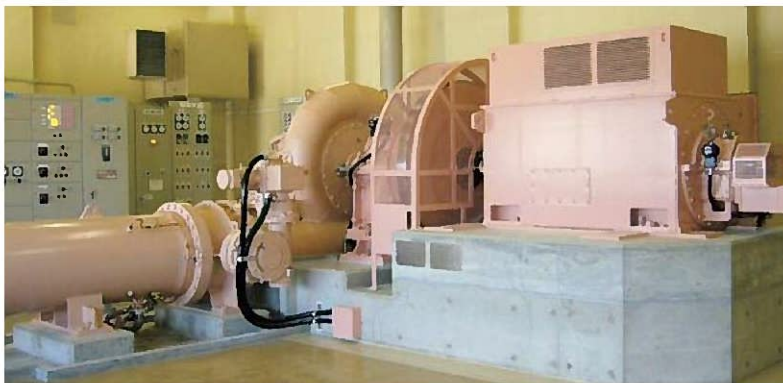
藻岩浄水場の水力発電設備
