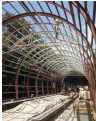
南北線開業に向けたシェルター工事の様子 Shelter construction for the opening of the Namboku Line
