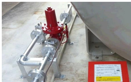
緊急遮断装置
