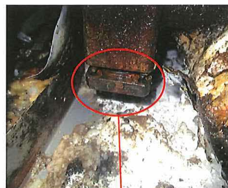
冷媒漏洩の発生箇所
