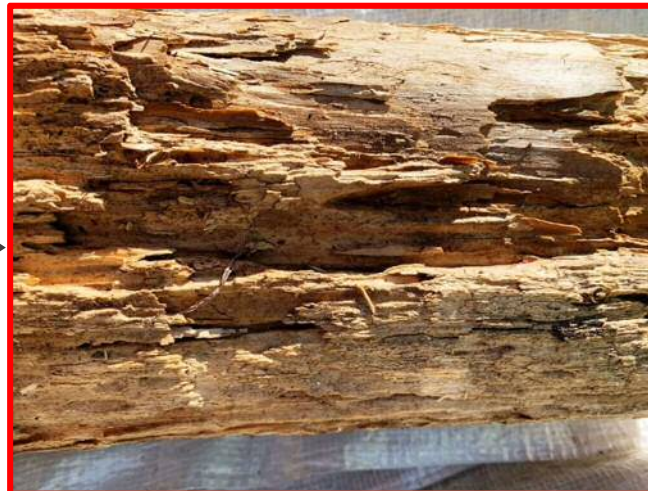
全体的に腐朽が進むため、バラバラしている
