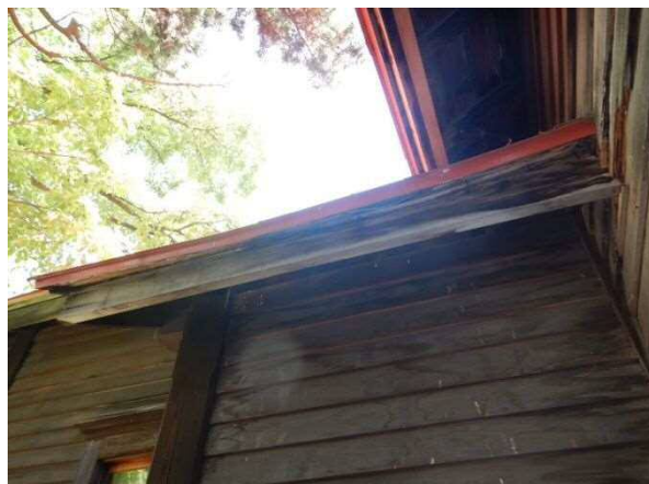
腐食による屋根変形
