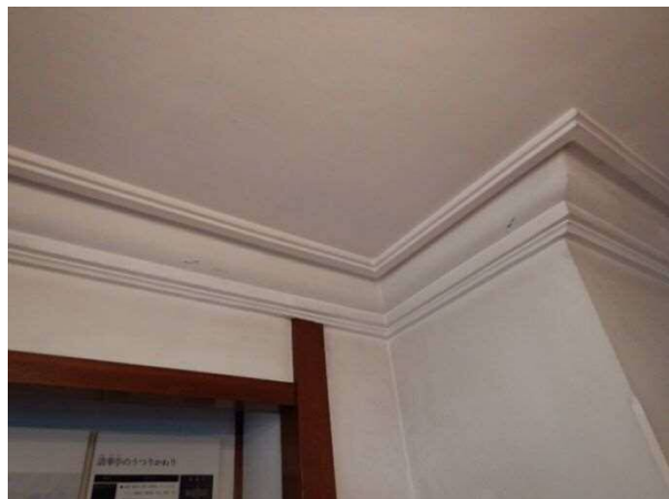
塗装の剥がれ
