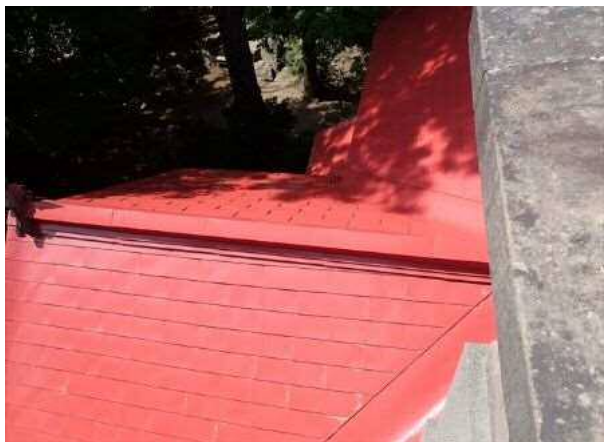
塗装の剥がれ
