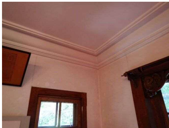
仕上げ面ひび割れ
