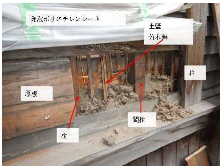
外壁1 (台所付近)
