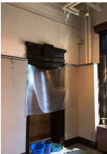
設備配管からの漏水
