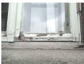
木製窓枠の腐朽
