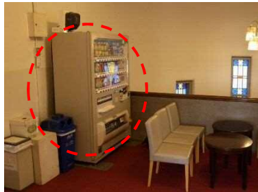
2階廊下に設置された 自動販売機
