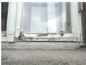
木製建具の腐朽
