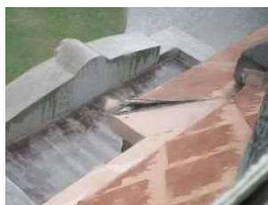
屋根材のはがれ
