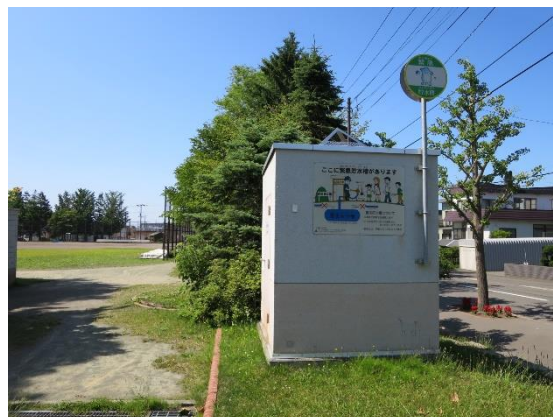
公園に設置された緊急貯水槽
