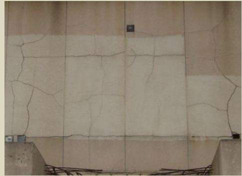
築30年 外壁のひび割れが発生
