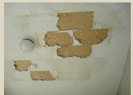
築41年 漏水による天井材の劣化
