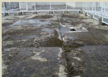
築27年 屋上コンクリートの劣化
