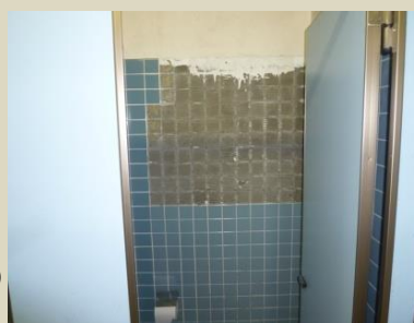
築43年 トイレの内部のタイルが剥落
