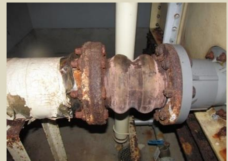
築32年 給水設備の老朽化
