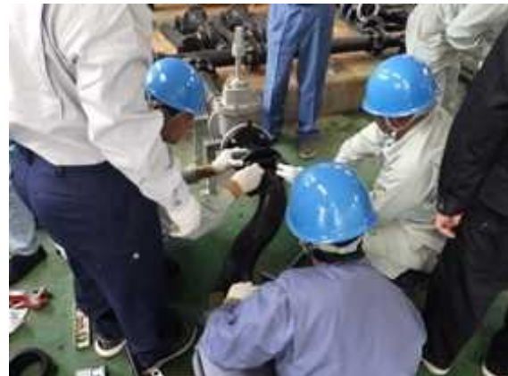
上水道の配管実習の様子 JICA 課題別研修「上水道施設技術総合（B）」
