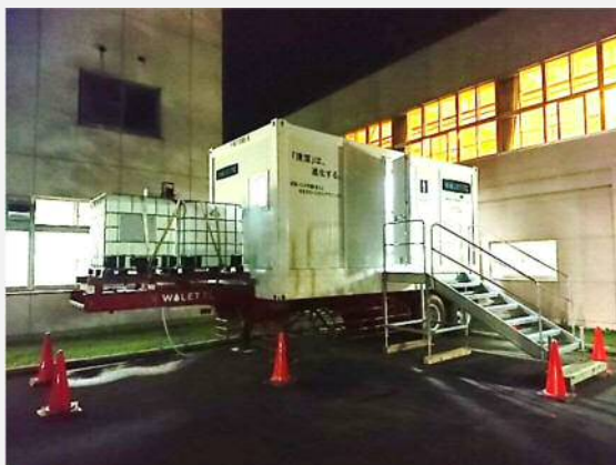
支援により設置されたトイレの状況
