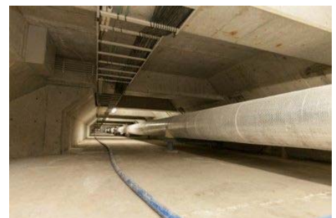
地下歩行空間地下ピット内の冷水導管幹線
