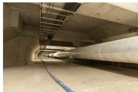
地下歩行空間地下ピット内の冷水導管幹線
