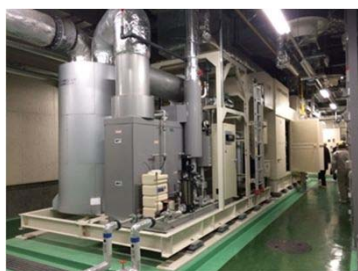
天然ガスコージェネレーション （地下4階）
