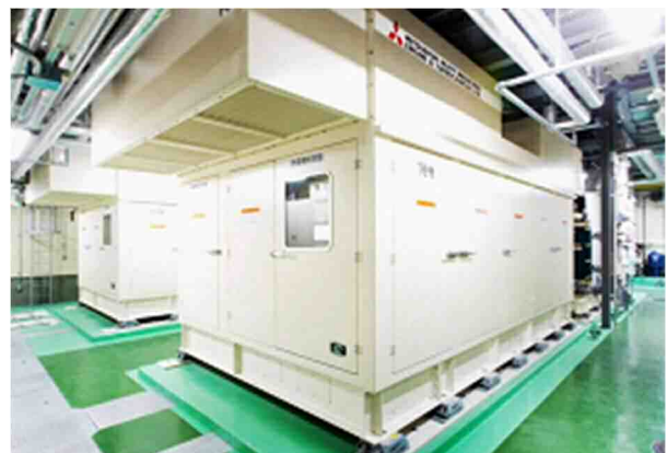
創世エネルギーセンターのガスエンジン発電機
