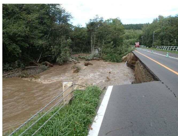
平成26年9月11日豪雨での被害状況
