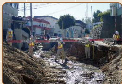
地震による被害の状況調査 2018年(平成30年)9月
