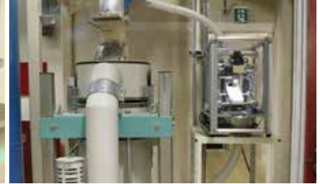
コンパクトに仕上がった自動計測装置(写真右側)
