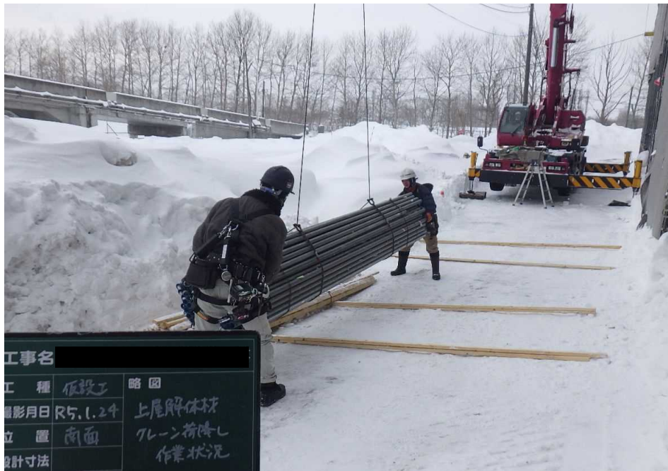
写真1 直接つり荷に触れて作業を行っている事例
