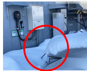
<降雪時のEV充電（充電ケーブルあり）>
