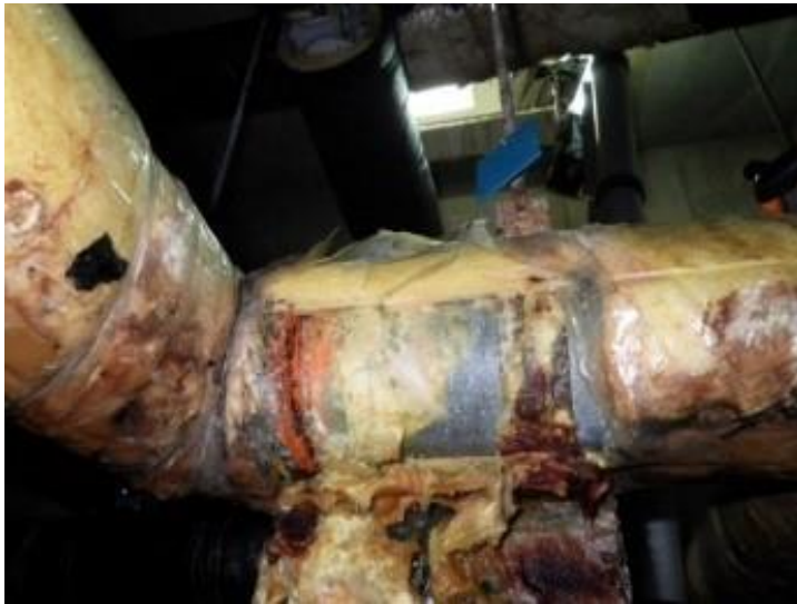
給排水設備の配管の腐食状況
