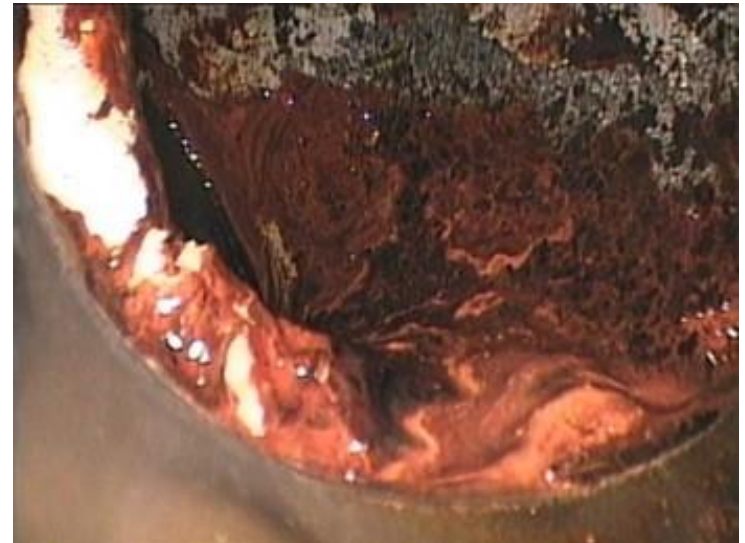
給排水設備の配管の腐食状況
