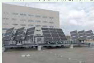
太陽光パネル
