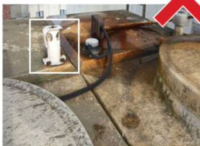
通気笠が破損し開放状態
