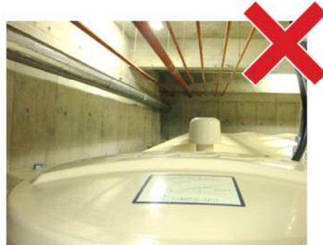
貯水槽上部に重油配管
