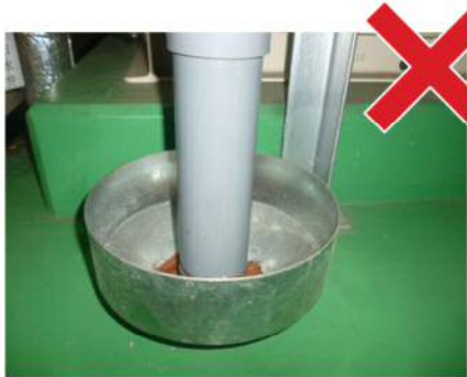
OF管の排水口空間無し
