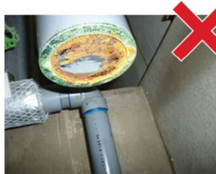
防虫網の破損
