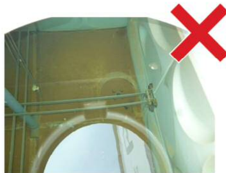
貯水槽内に沈殿物
