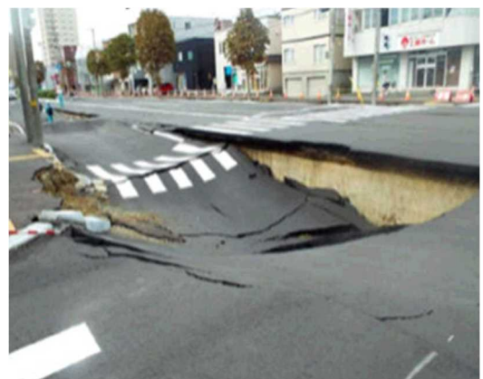
図 3-6 北海道胆振東部地震（2018）による道路の陥没
