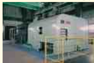
蒸気タービン発電機
