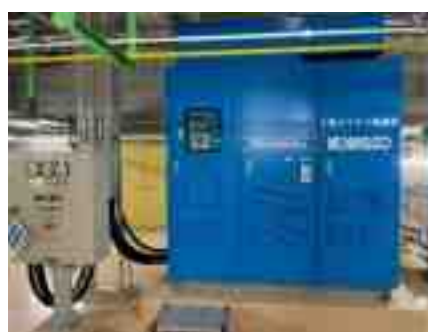
図 3-9 蒸気発電設備
