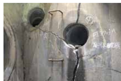
地震被害の状況 (マンホールの破損)
