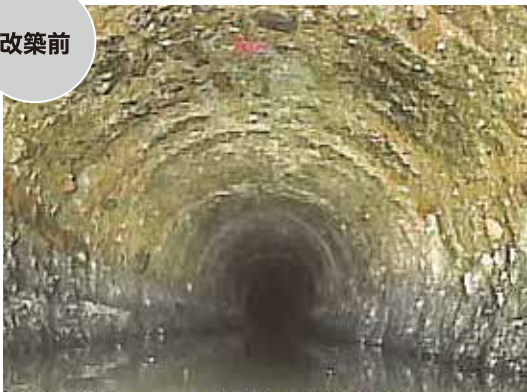
内面が腐食した管路
