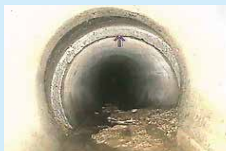
管路のつなぎ目のずれ
