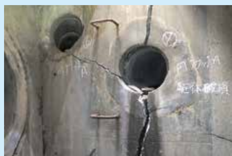
マンホールの破損
