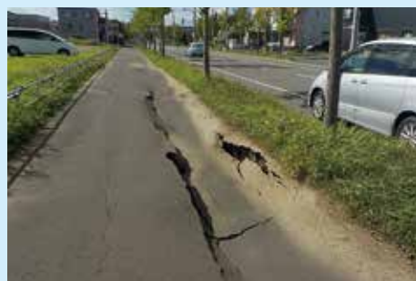
管路上部の地盤沈下
