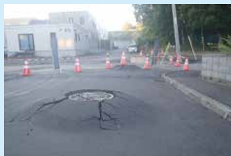
マンホールの浮き上がり
