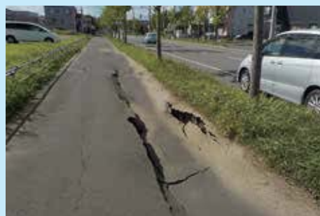
管路上部の地盤沈下
