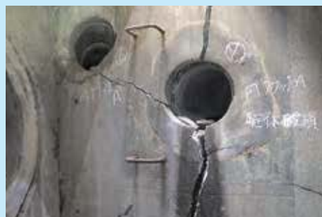
マンホールの破損
