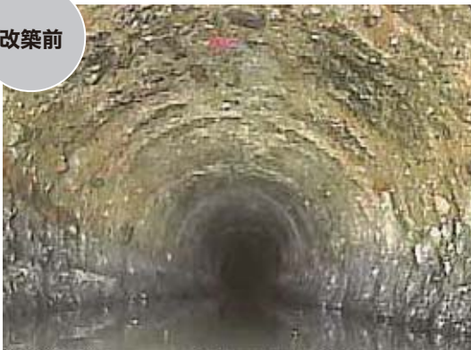
内面が腐食した管路
