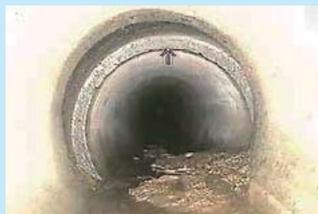
管路のつなぎ目のずれ
