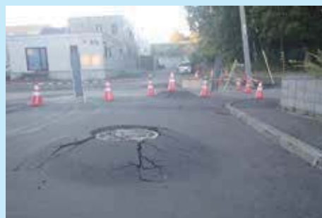
マンホールの浮き上がり
