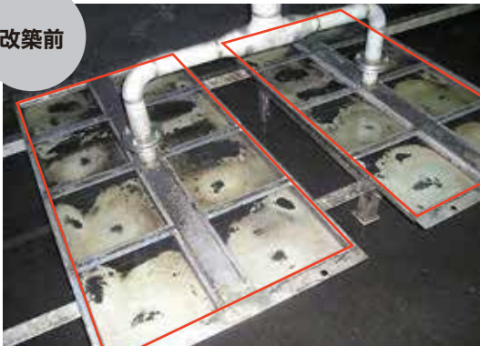
( 劣化により機能が低下した散気装置 )
