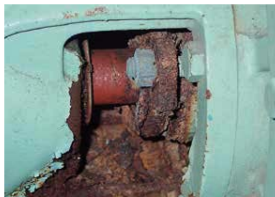
処理施設の老朽化の状況（腐食・劣化したポンプ設備）
