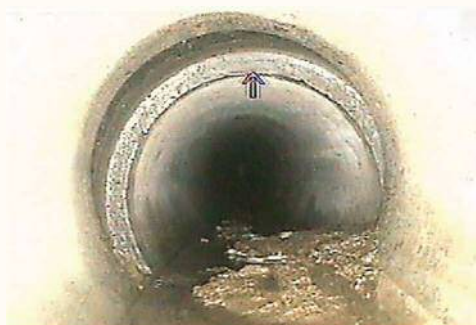
管路のつなぎ目のすれ
