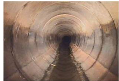
1926年に整備した最古の本管
