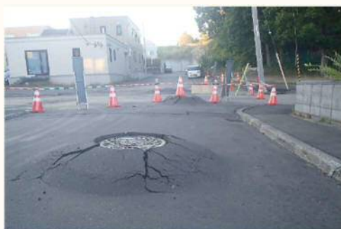
マンホールの浮上
