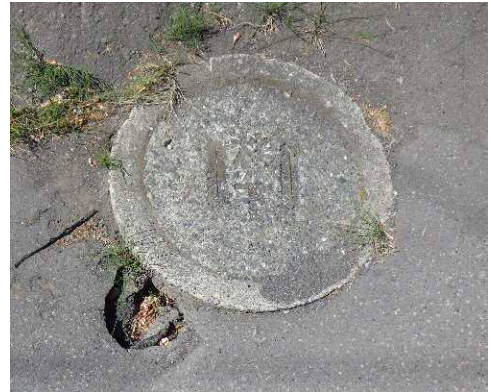
取付管に起因する道路陥没例 (公共樹と取付管の接合部のズレ)
