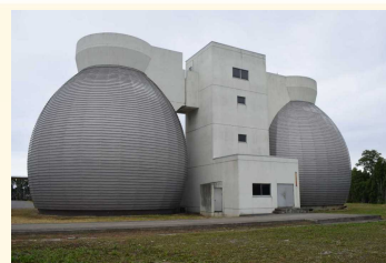
消化槽 (岩見沢市 南光園処理場)
