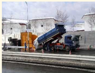
八軒下水道管投雪施設
