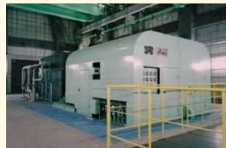
蒸気タービン発電機
